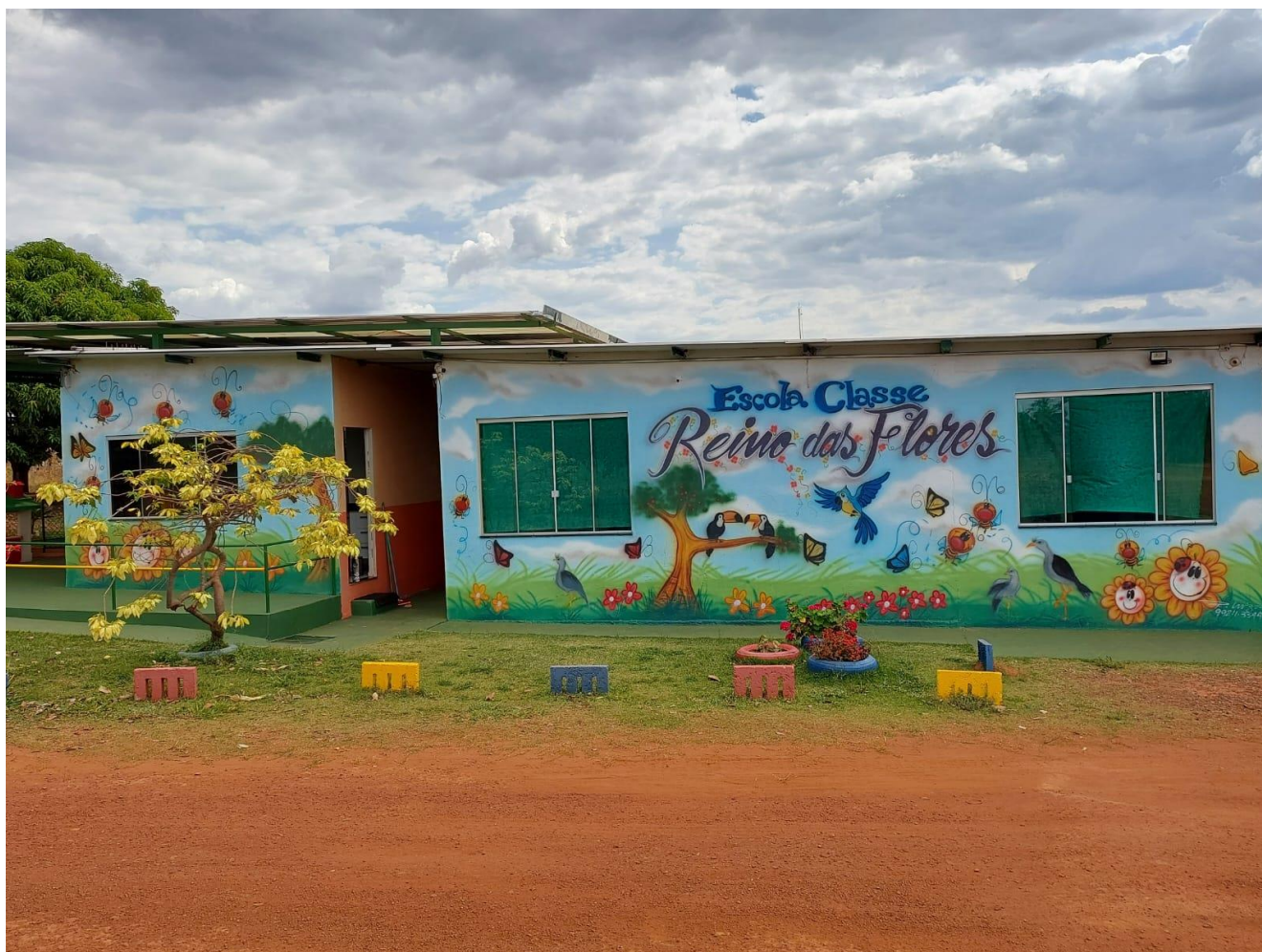
Foto de 2023, após reparos realizados em 2023.
