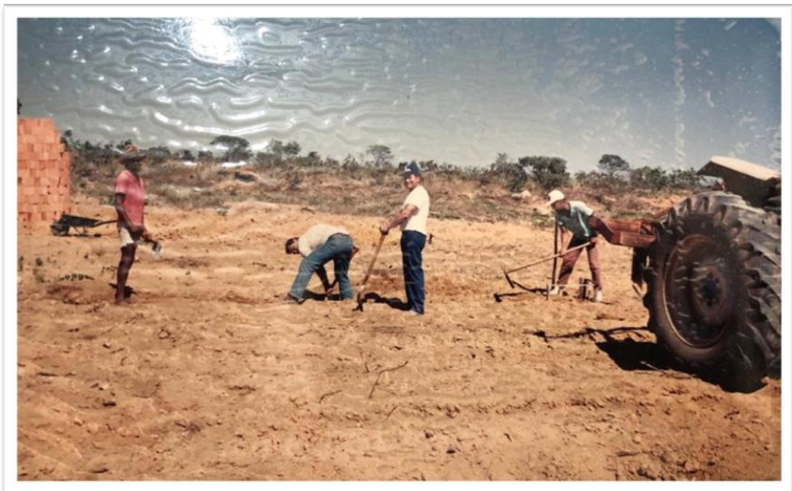
Integrantes da Associação de Criadores e Produtores escavando a fundação do até então prédio da associação.
