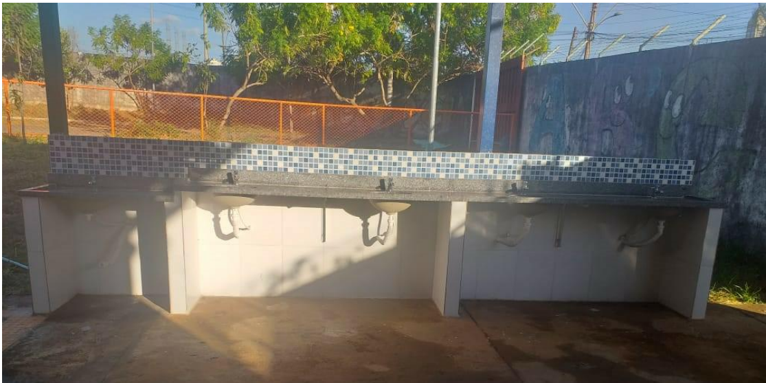
Instalação de lavatório na entrada da escola (uma das medidas sanitárias de combate à COVID19).
