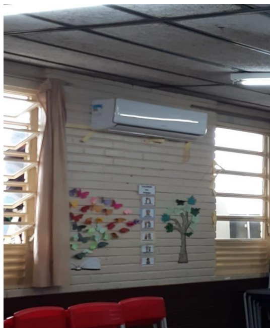
Instalação de Ar condicionado em todas as salas de aula
