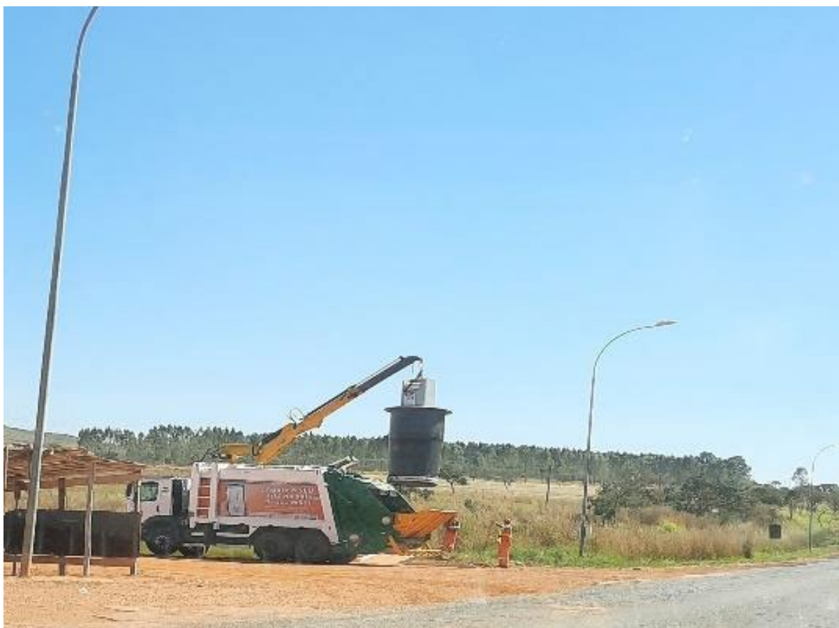
(Figura 41 – Papa-lixo instalado na entrada de acesso à Cerâmica Santa Maria)
