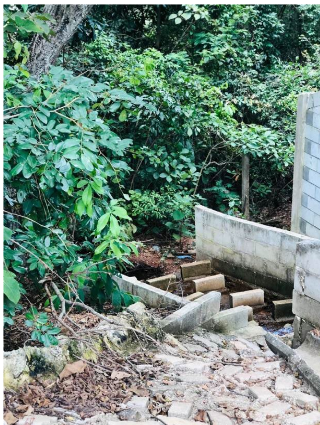
(Figura 57 - Conforme informação do funcionário Genivaldo a partir desse ponto começa a APP e ninguém do condomínio é autorizado a entrar na área)
