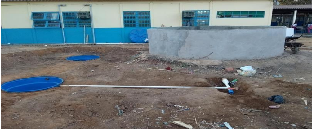
Figura 4: Foco no encanamento que liga o tanque de peixes com os tanques anexos.
