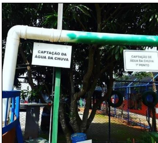
Figura 37 - Sistema de captação da água da chuva
